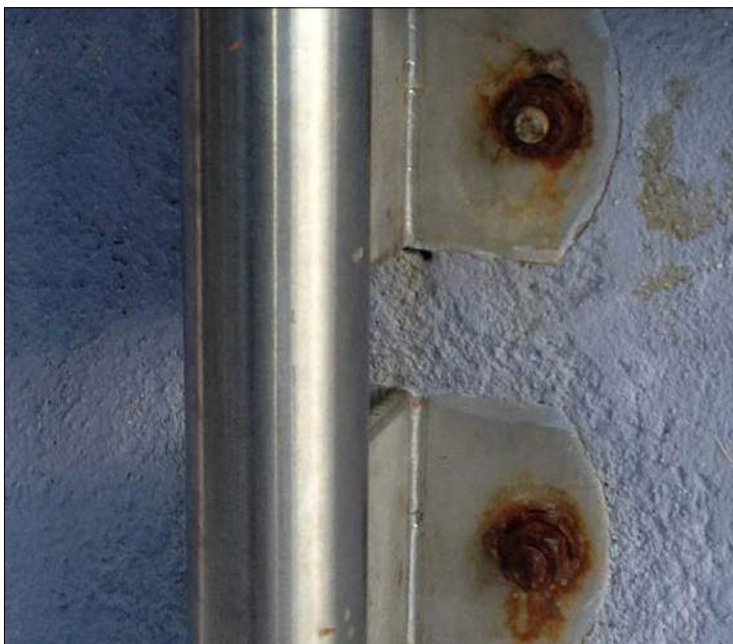
Abbildung 3: Beispiel für Kontaktkorrosion, Edelstahlgeländer verzinkter Verschraubung
